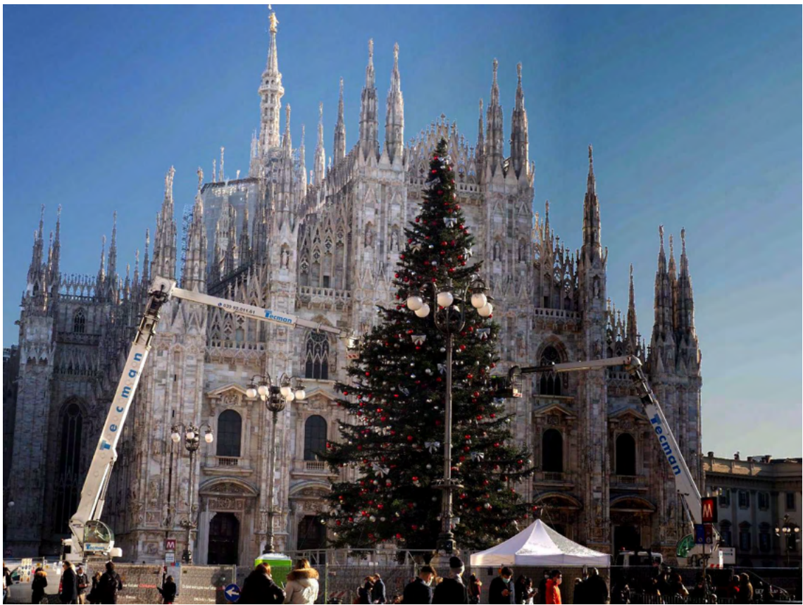
大聖堂前広場では、巨大クリスマスツリーが大型高所作業車を使用しての飾り付け中だった。12月に入ったせいか、大聖堂脇にはクリスマスセール露店が並び、ムードが一気に盛り上がっている。 21/12/03 11:31 28 mm F8 1/250sec ISO200
